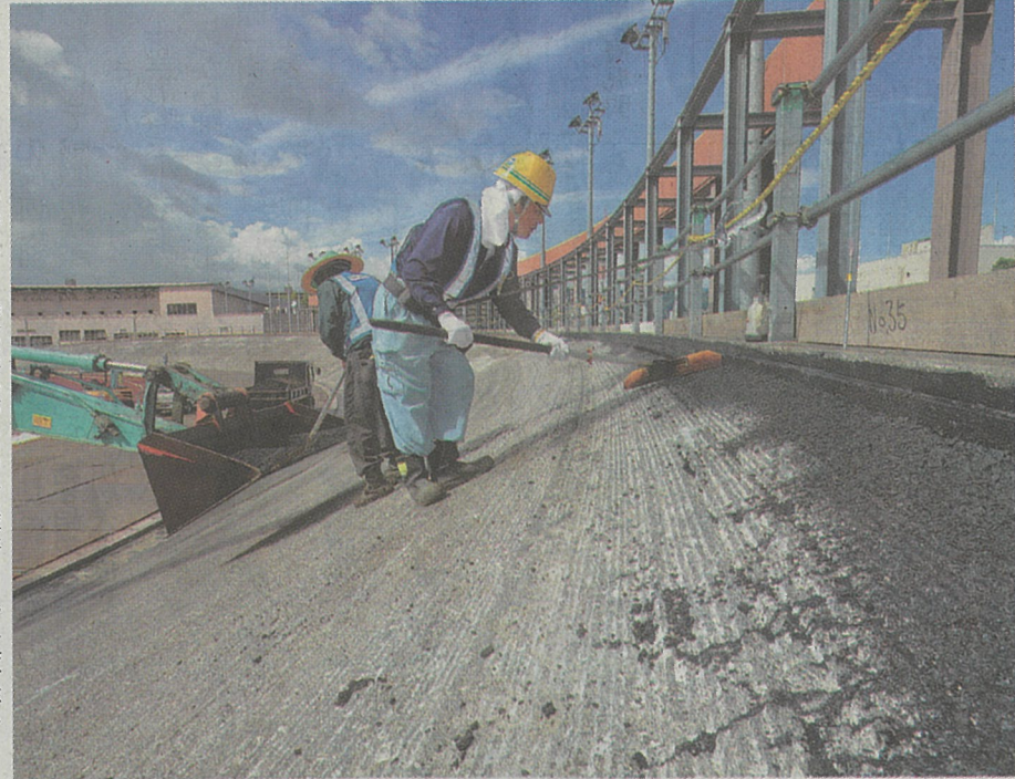
急斜面のバンク。男性は命綱を着けて作業中 (高知市大原町、いずれも佐藤邦昭撮影)
